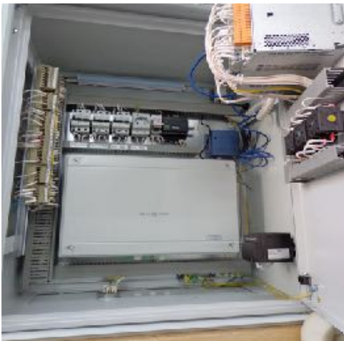
Рис.2 общий вид шкафа управления
